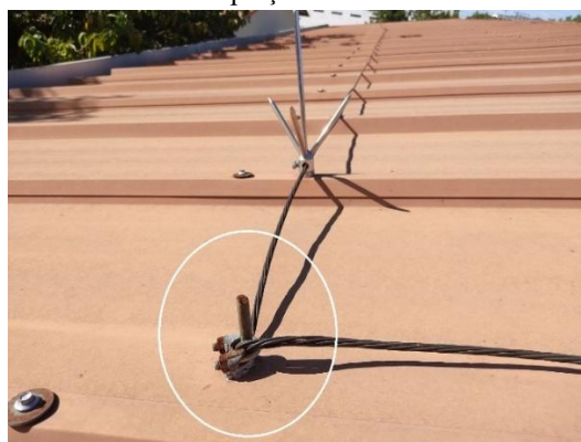
Figura 34 – Uma das conexões entre a captação e o subsistema de descida do módulo didático
