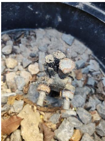
Figura 36 – Uma das hastes de aterramento do módulo didático
