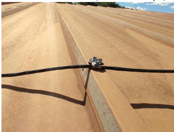
Figura 33 – Presilha para cabo de cobre usada na fixação da malha de captação do módulo laboratorial
