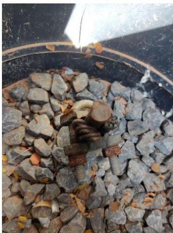
Figura 37 – Uma das hastes de aterramento do módulo laboratorial
