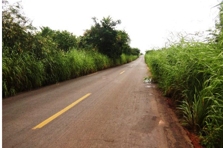
Figura 35 – Vegetação sobre a rodovia, e ausência de sinalização.
