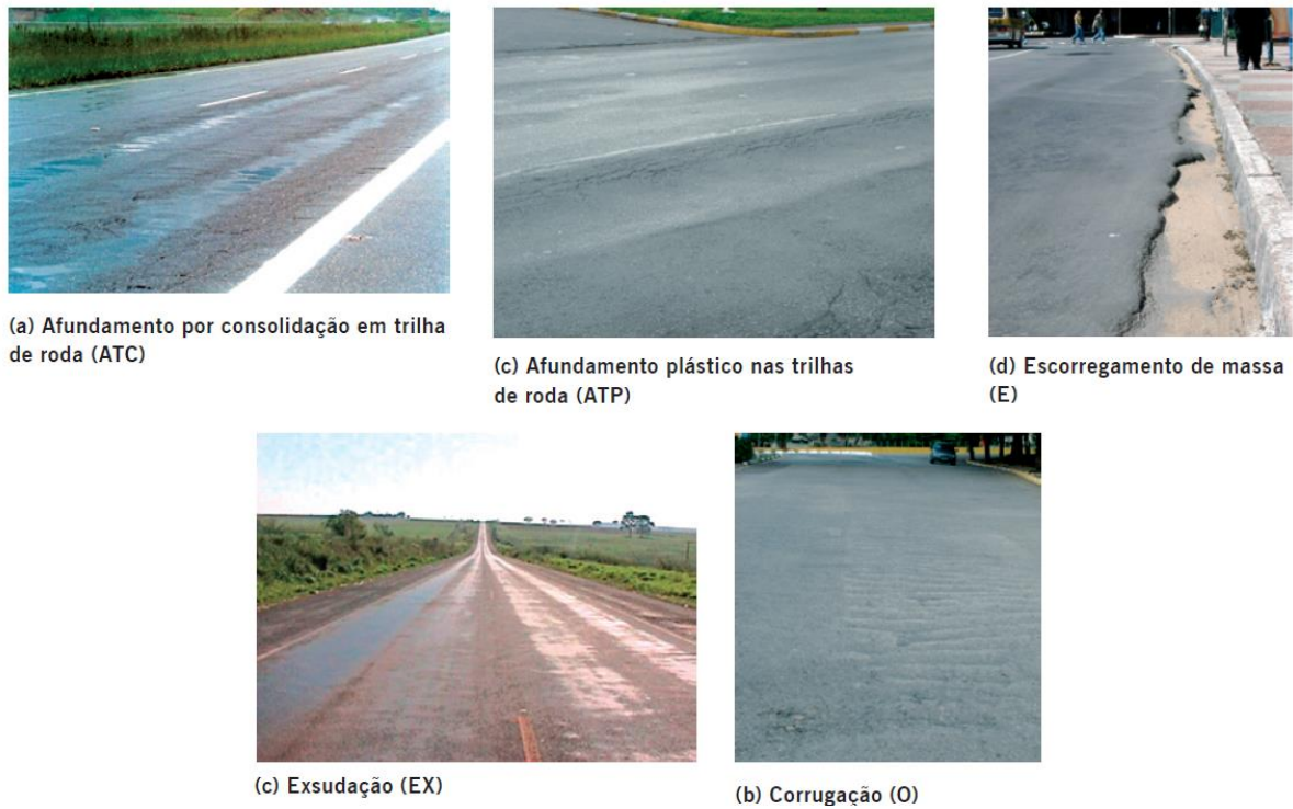
Figura 7 – Exemplos de problemas com Afundamento, Escorregamento, Corrugação e Exsudação.
