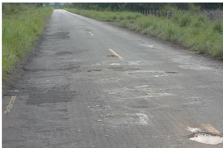
Figura 31 - Ocorrência de remendos no pavimento.
