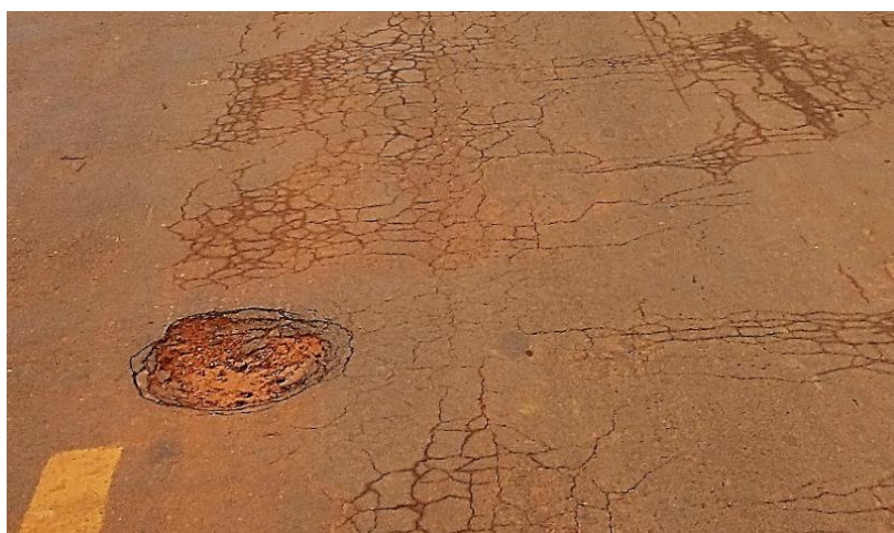
Figura 28 - Exemplo das trincas e panela presente no pavimento.
