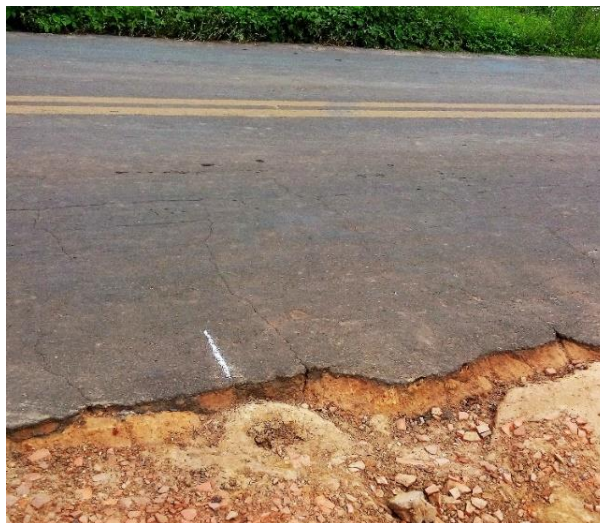
Figura 32 - Exemplo de desgaste lateral da superfície do pavimento.
