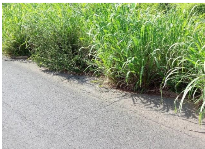
Figura 34 - Ausência de sistema de drenagem.
