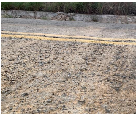
Figura 22: Exemplo de desgaste presente na rodovia.
