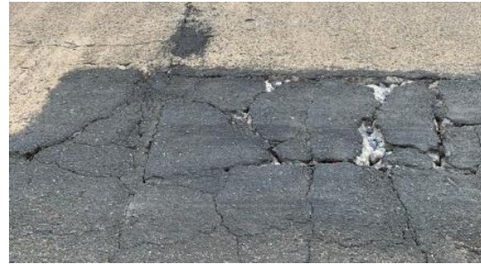
Figura 33: Buraco presente na via.
