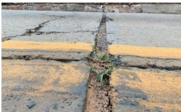
Figura 28: Exemplo de falha nas juntas de dilatação presente na rodovia.
