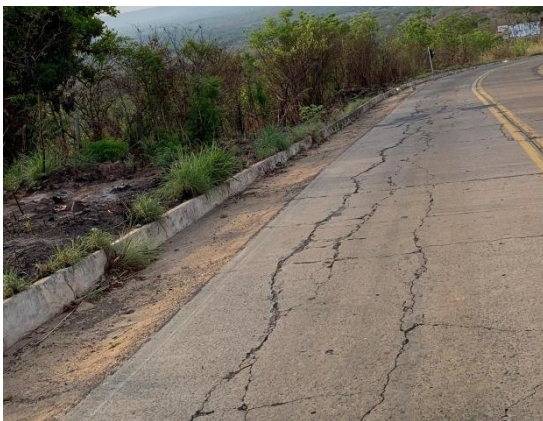
Figura 30: Fissuras presentes no trecho.
