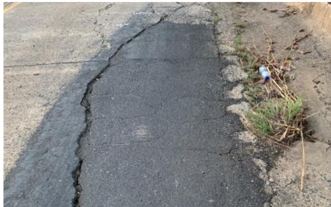
Figura 29: Tentativa de reparo.
