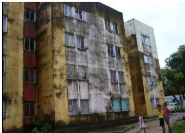
Figura 8- Mofo ou bolor em fachada argamassada
