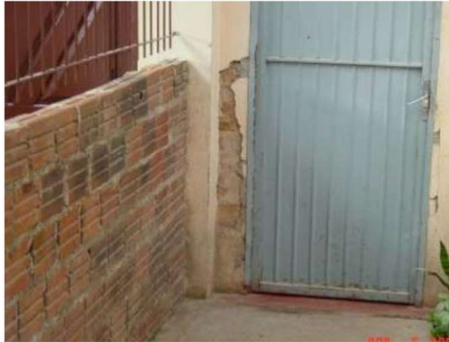
Figura 5- Descolamento em placas
