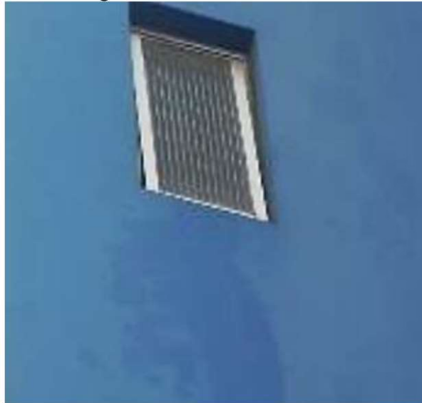
Figura 7- Mancha de umidade
