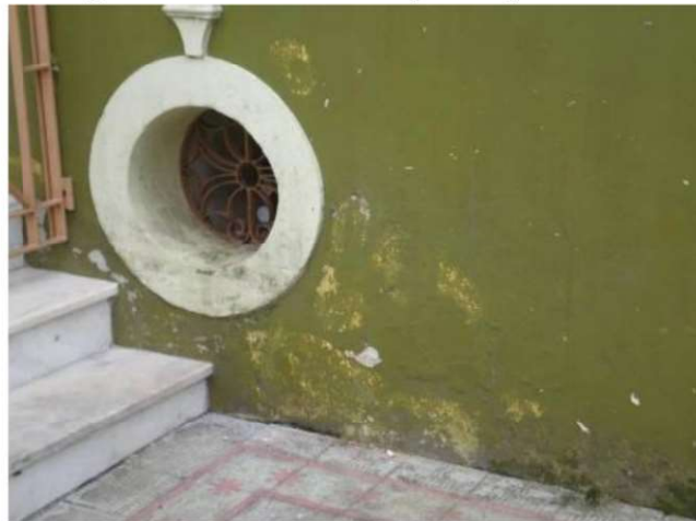
Figura 4 - Descolamento por empolamento
