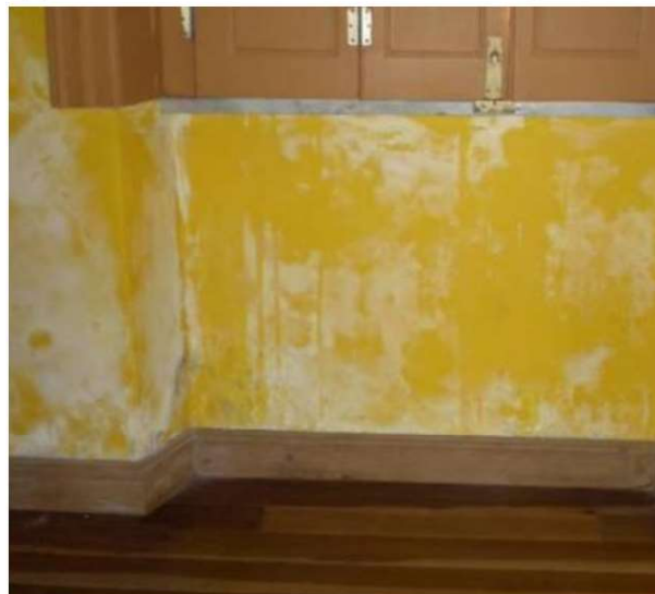
Figura 9- Eflorescência em fachada argamassada
