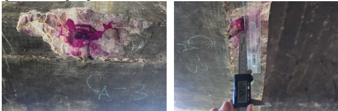
Figura 76 – Resultado colorimétrico de aspersão de solução de fenolftaleína, na Zona CA-3, na região interna da viga longarina A.
