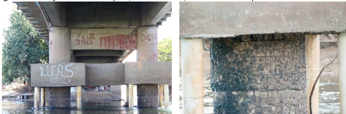
Figura 65 – Conjunto central de pilar, no leito do rio, com armadura exposta.
