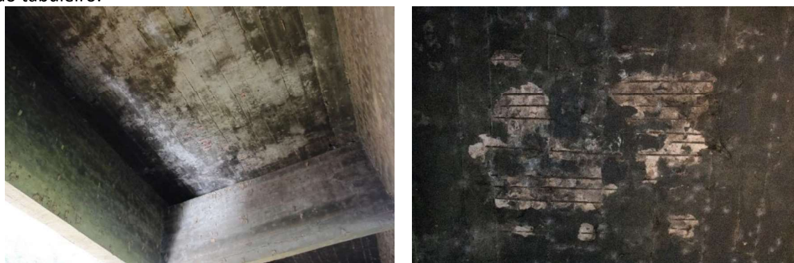
Figura 59 – Deslocamento de concreto da camada de cobertura e corrosão da armadura na laje do tabuleiro.
