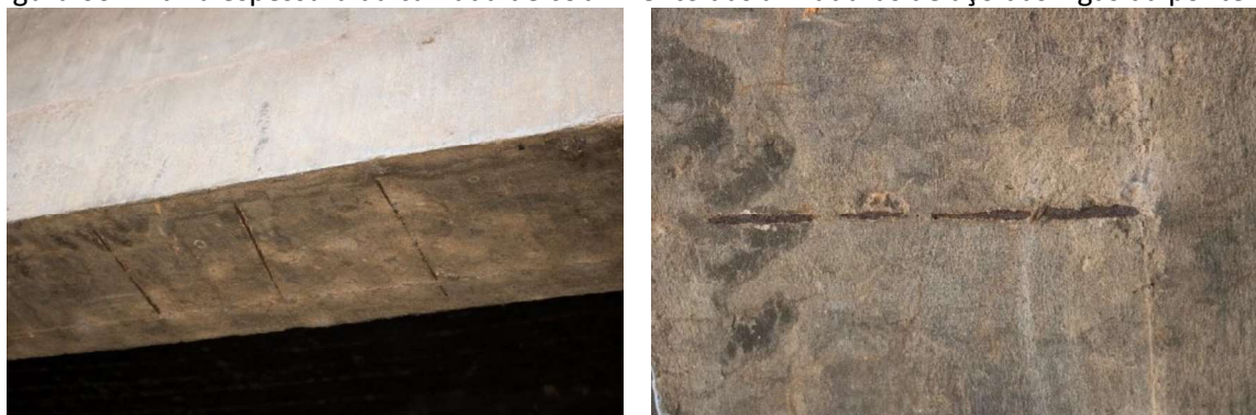
Figura 60 – Baixa espessura da camada de cobrimento das armaduras de aço das vigas da ponte.
