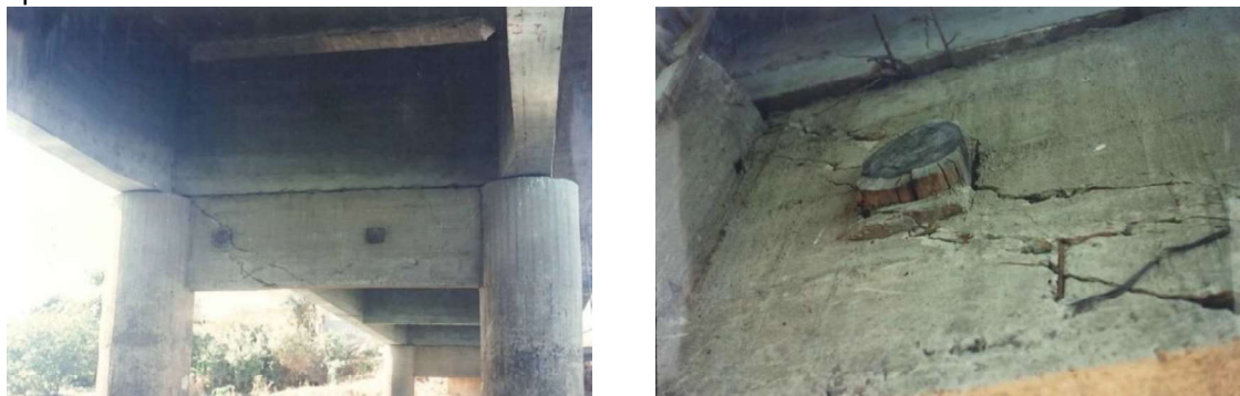
Figura 53 – Travessa de ligação entre os pilares centrais com rachadura angulada e armadura exposta.
