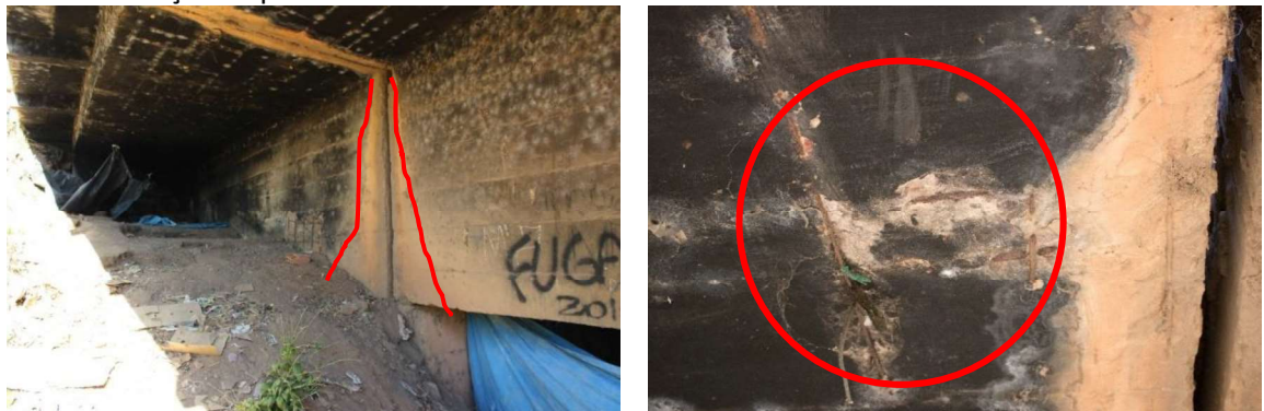
Figura 67 – Junta de dilatação da cabeceira inspecionada, com marcas de escoamento de água e corrosão do aço nas proximidades.
