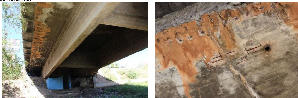
Figura 62 – Detalhe de manifestação patológica decorrente de sistema de drenagem dos passeios deficiente.
