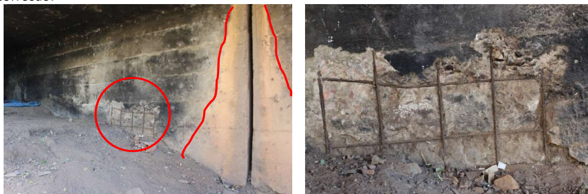
Figura 68 – Região do viaduto de acesso (muro de contenção) com deslocamento e armadura sob corrosão.
