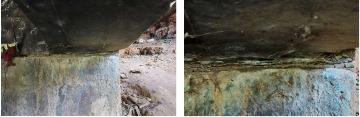
Figura 66 – Neoprene do aparelho de apoio da cabeceira em grau avançado de deterioração.
