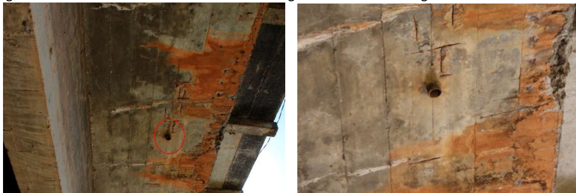
Figura 52 – Tubos metálicos do sistema de drenagem das faixas de rolagem.
