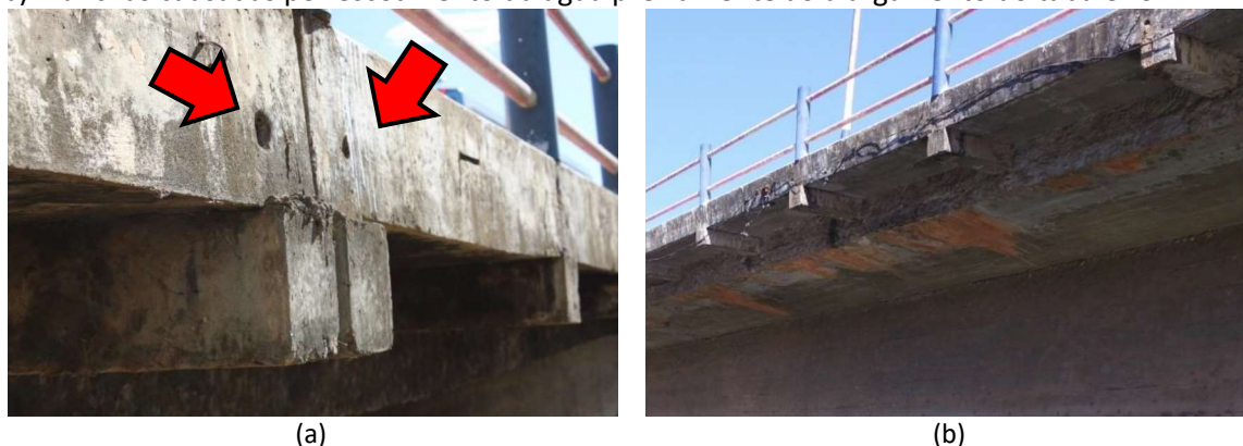
Figura 61 – Detalhe do sistema de drenagem dos passeios (a) tubo polimérico sem prolongamento; (b) manchas causadas por escoamento da água previamente ao alargamento do tabuleiro.
