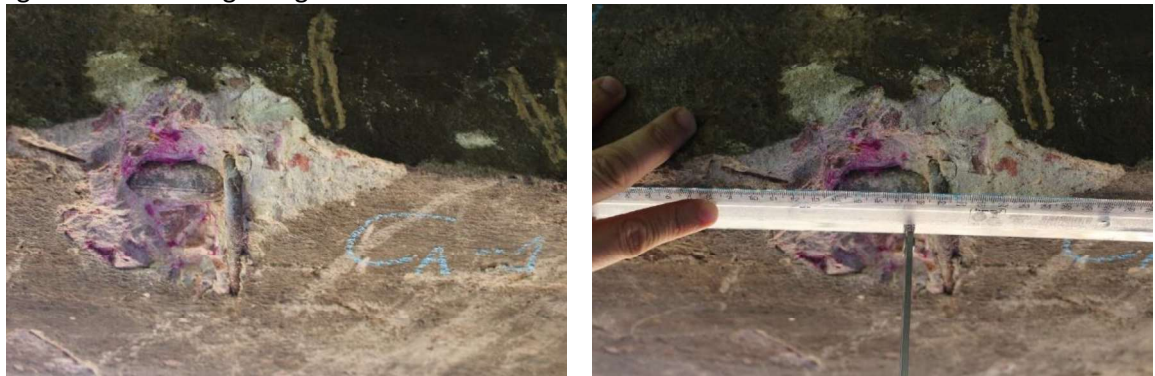
Figura 74 – Resultado colorimétrico de aspersão de solução de fenolftaleína, na Zona CA-1, na região interna da viga longarina B.
