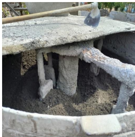
Figura 12 - Homogeneidade dos Materiais no Misturador.
