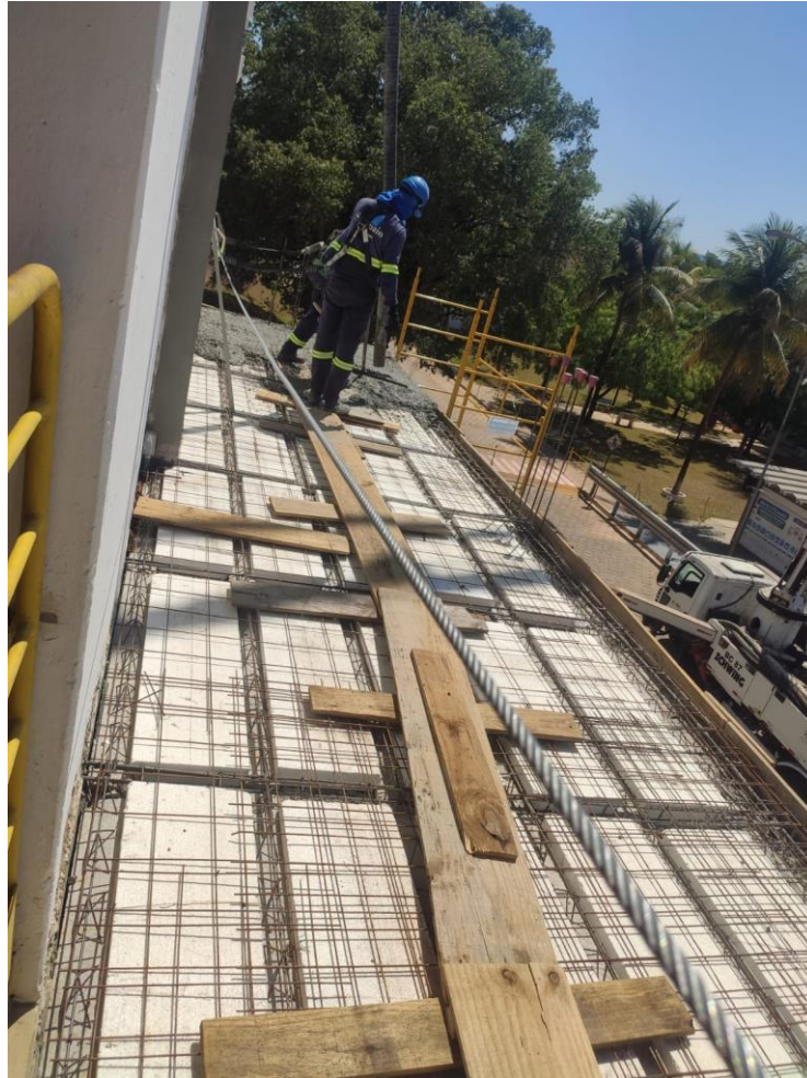
Figura 57 - Colaboradores transitando na laje em cima de tábuas de madeira
