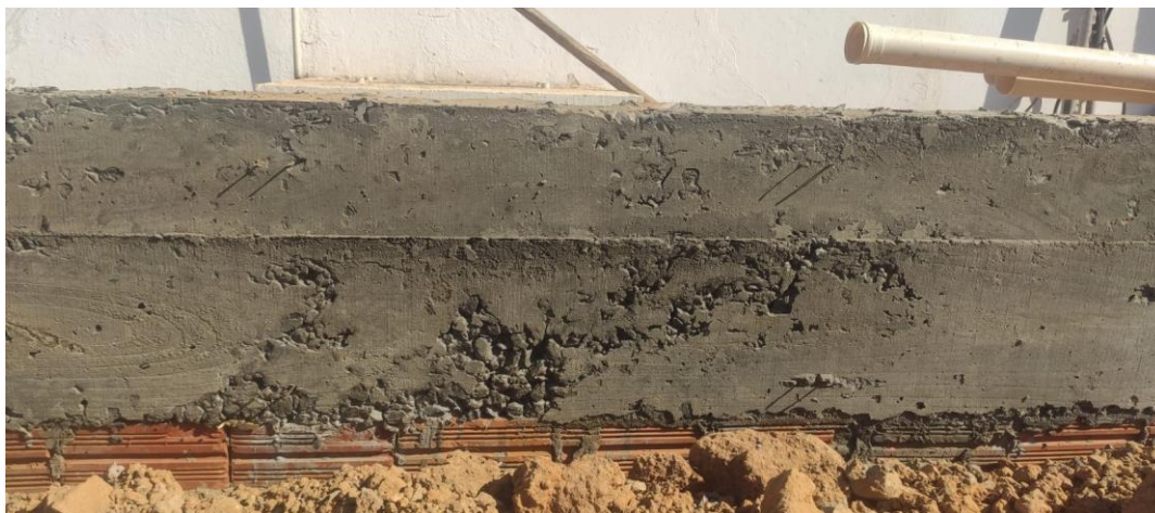
Figura 42 - Pontos de segregação e vazios observados após retirada da fôrma
