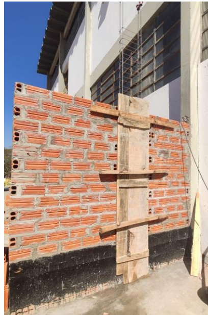
Figura 27 - Pilar travado com estacas de madeira externas
