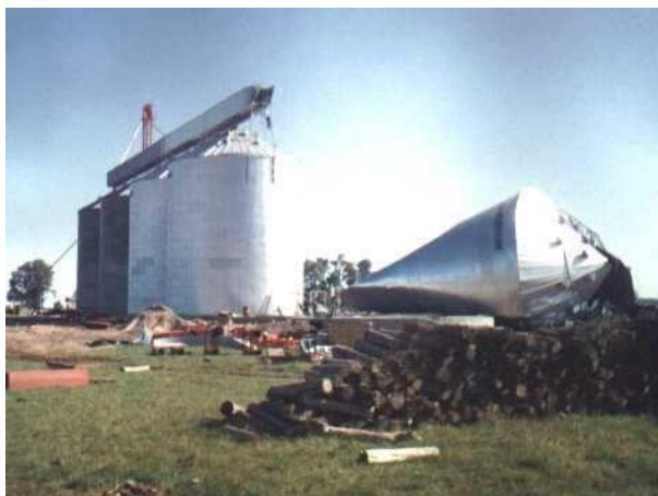
Figura 2 – Silo tombado durante a montagem devido a erros durante a execução
