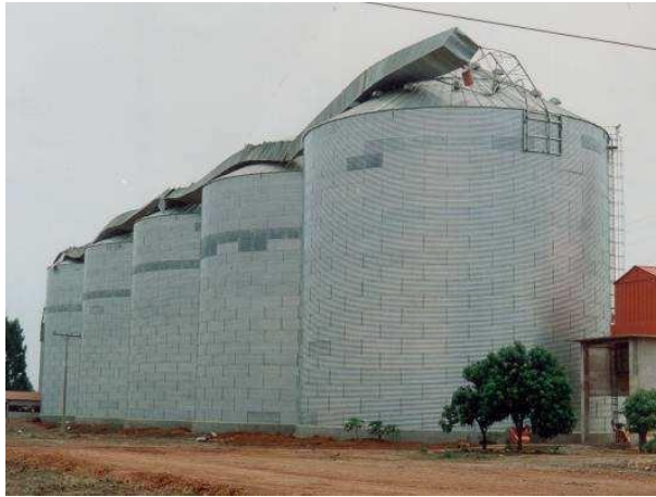
Figura 4 – Colapso em galeria de silos devido a ação de ventos superiores ao dimensionado
