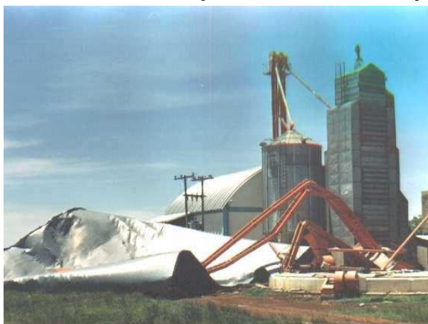
Figura 3 – Acidente de silo devido a elevação da estrutura com objetivo de ampliação
