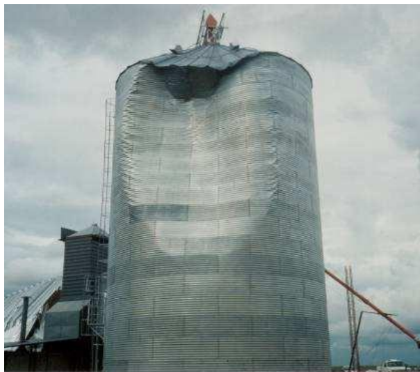
Figura 5 – Falha estrutural devido falha no dimensionamento da estrutura
