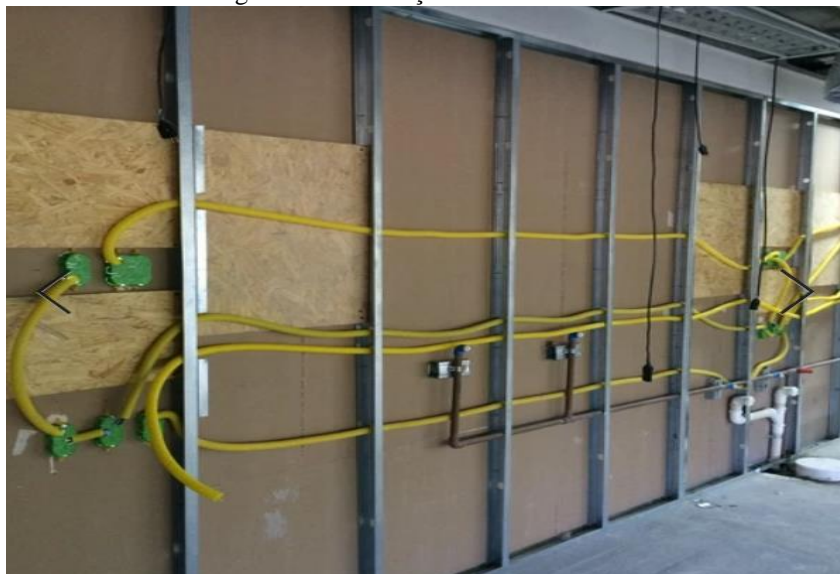
Figura 13 - Tubulação elétrica embutida.
