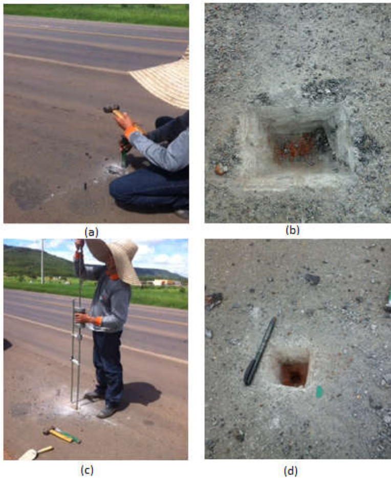
Figura 20 – (a) Remoção da camada de pavimento asfáltico; (b) Seção de abertura do pavimento para realização do ensaio com DCP; (c) Realização do ensaio; (d) Furo após realização do ensaio DCP.
