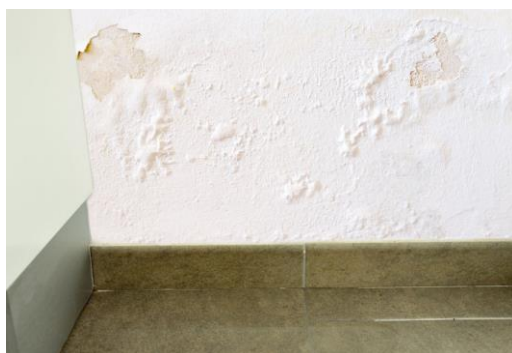
Figura 9 - Umidade ascensional com presença de bolhas no revestimento
