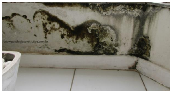
Figura 10 - Umidade ascensional com presença de mofo no revestimento
