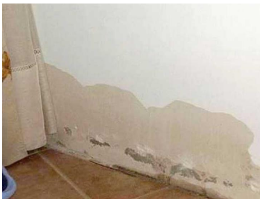
Figura 8 - Umidade ascensional com presença de deslocamento próximo ao rodapé da parede
