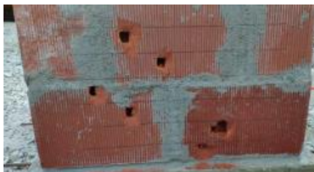
Figura 12 - Protótipo de parede após ser submetido ao ensaio gravimétrico com retirada de amostras
