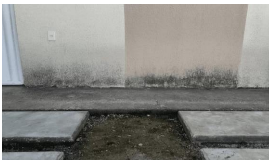
Figura 4 - Mancha de umidade ascensional em parede de SRA com manifestação de mofo
