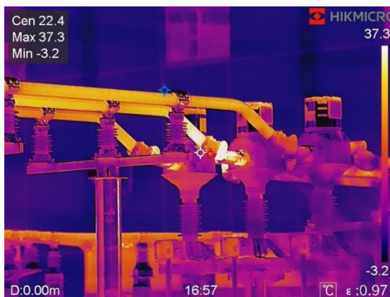
Figura 15 - Termograma gerado em uma avaliação de estação de energia elétrica
