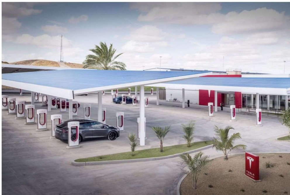
Figura 2: Estação de recarga Supercharger da Tesla.
