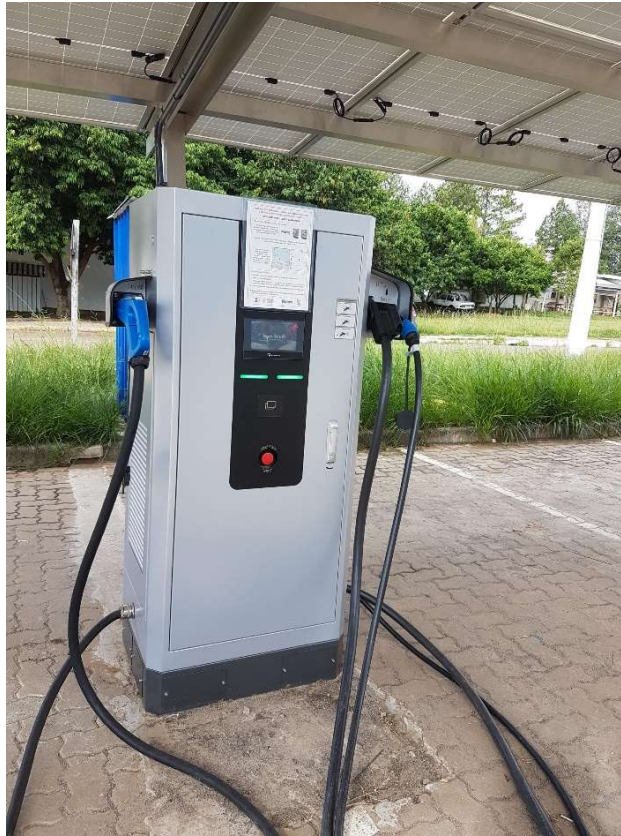
Figura 5: Estação pública de carregamento rápido tipo DC.
