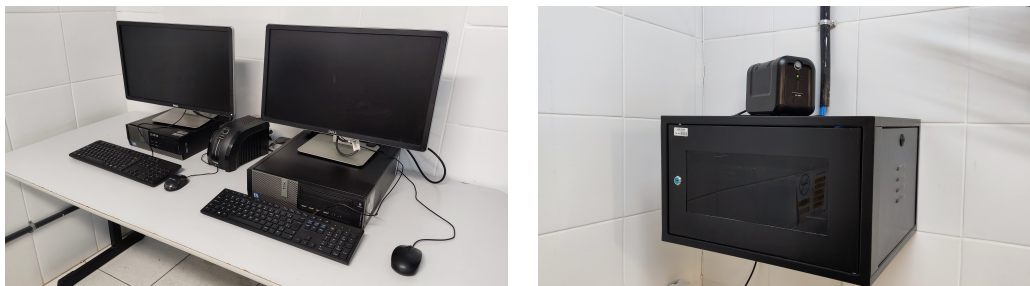
Figura 31 – Exemplos de equipamentos que utilizam no-breaks no CMBJL
