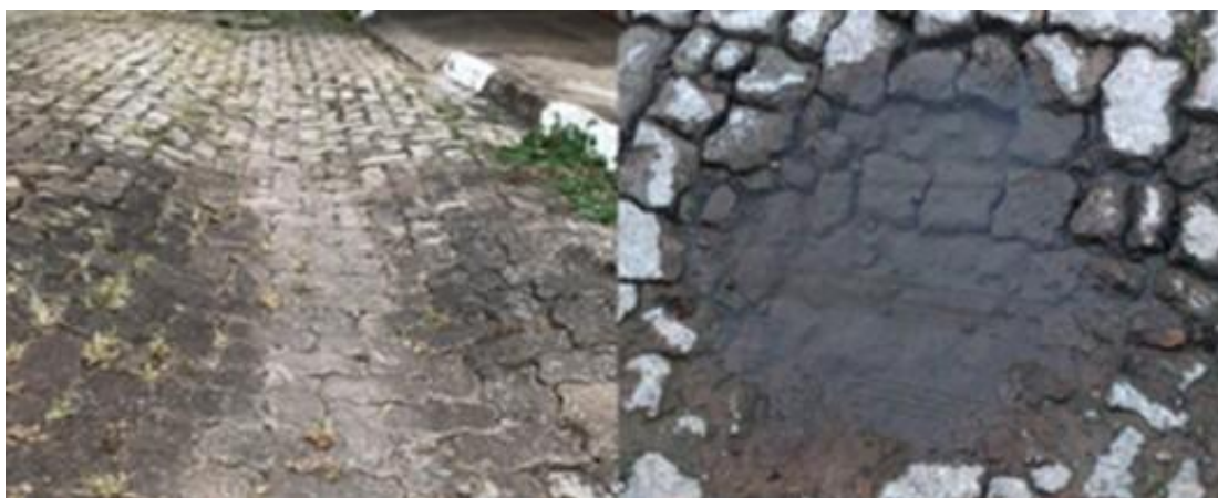
Figura 9: Registro de um pavimento de pavers com afundamento, recalque e peças quebradas, consequências diretas da não conformidade com a norma.
