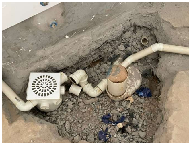
Figura 35: Bacia sanitária: Ligação de todo o esgoto na bacia sanitária.
