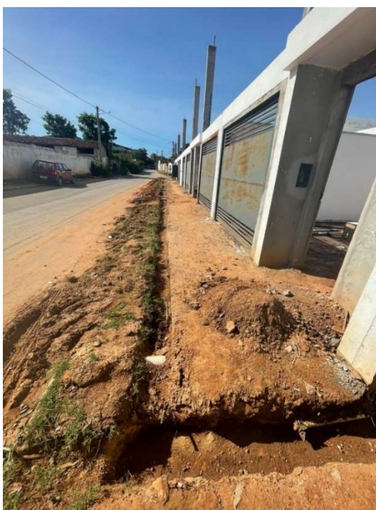
Figura 38: Correção da tubulação: nível da rua.
