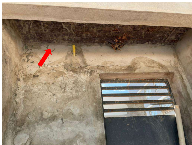
Figura 28: Fissuras na fachada – Casa Padrão B.
