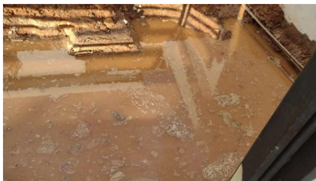
Figura 36: Alagamento decorrente das chuvas.
