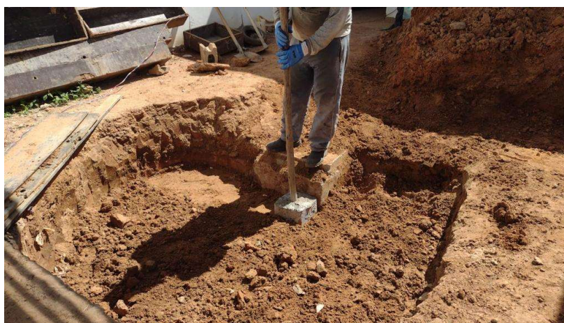
Figura 31: Compactação do solo.
