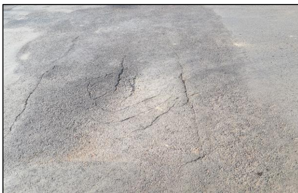
Figura 34. Defeito causado por manutenção no esgotamento público.
