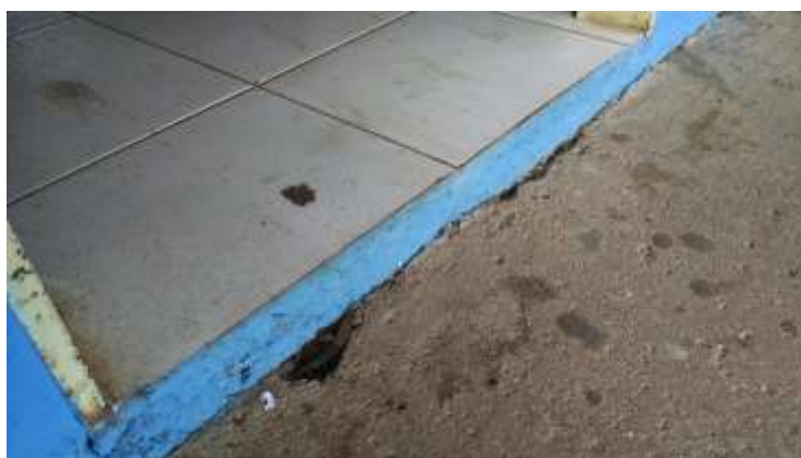
Figura 27 - Detalhe do desnível junto ao vão da porta.
