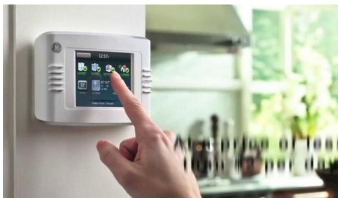
Figura 23 - Sistema de alarmes.
