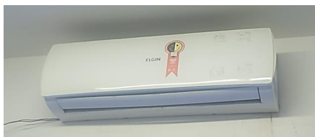
Figura 10 – Ar-condicionado do Berçário patológico
